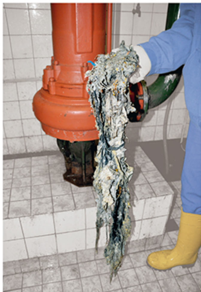
Sieht übel aus und ist es auch: verfilzte Feuchttücher. Regelmäßig legen sie Abwassersysteme lahm.
